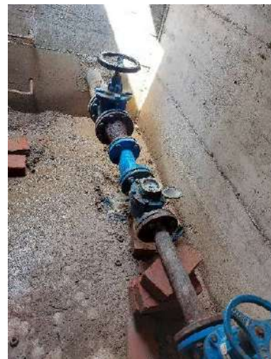
postojeće vodomjerno okno
